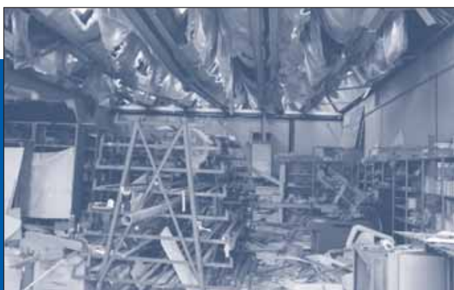
Explosion AZF à Toulouse du 21/09/2001 - Lycée Gallieni
